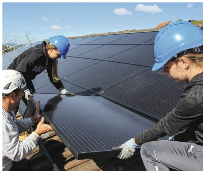
Zum Abschluss des ersten Programmjahres bauen die Schülerinnen und Schüler eine Solaranlage auf das Schulhausdach. Foto: myblueplanet
